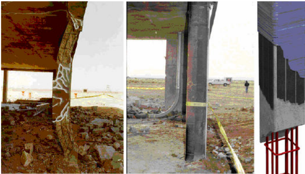
شکل 3- ستون تقویت شده با کامپوزیت FRP و آسیب دیده
